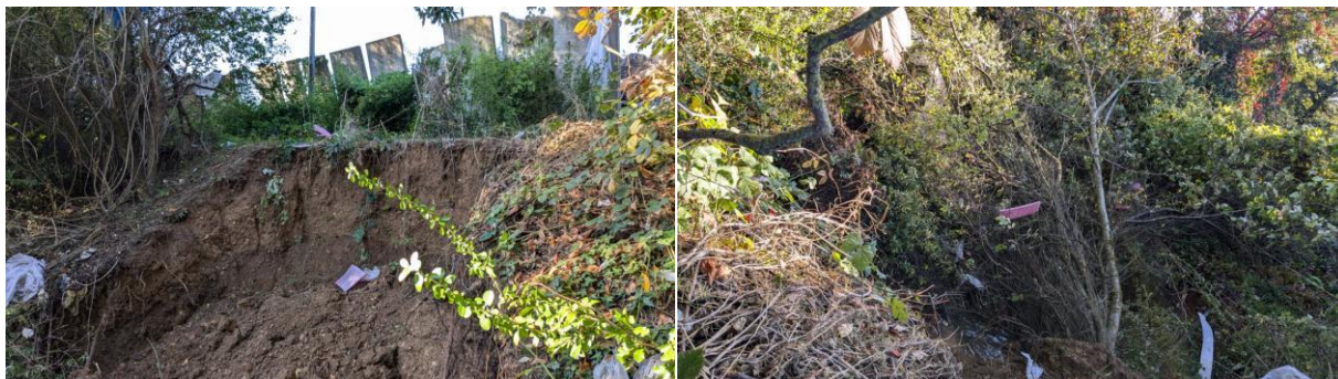
Effondrement derrière le centre Paprec (Photos : Cen CVL/S. Garbar)
