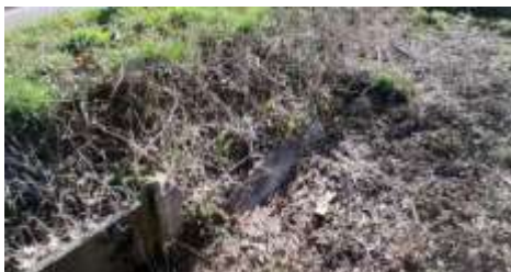
Dégradation du crapauduc – 19 mars 2025
